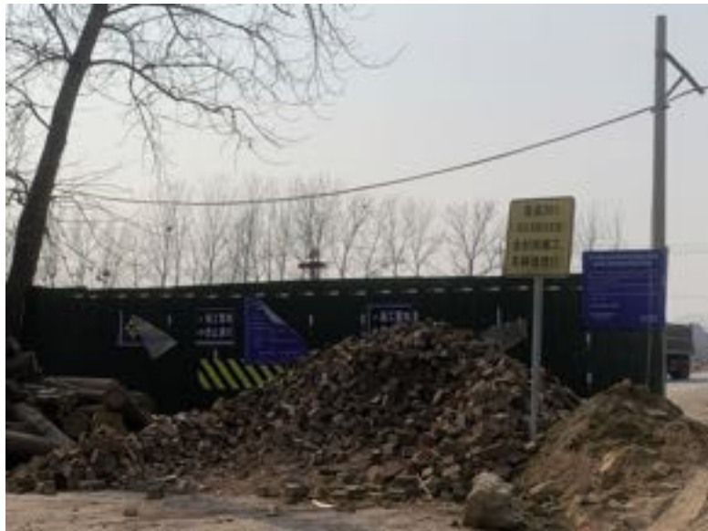
通往董集村及周边地区的道路被以施工为名封闭（朱迪拍摄）
